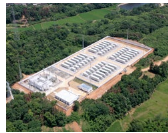
湘阴项目液冷儲能直流艙
