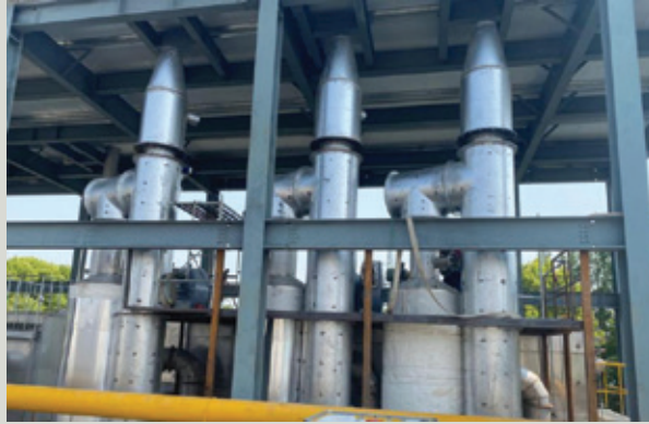
尾氣淨化系統現場
