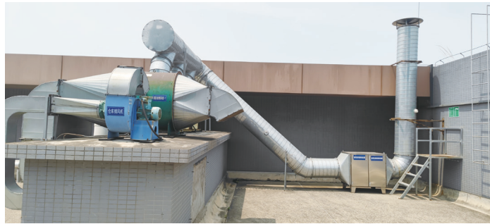
廢氣處置裝置
