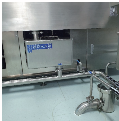
洗瓶機循環水暫存水箱
