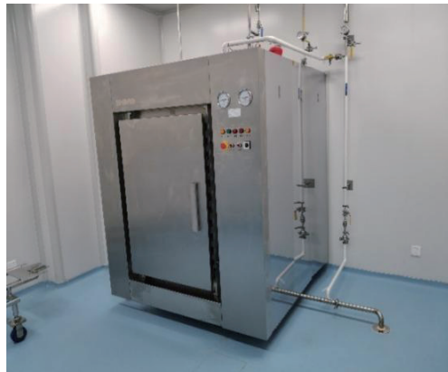
第一類廢渣處理高溫滅菌櫃
