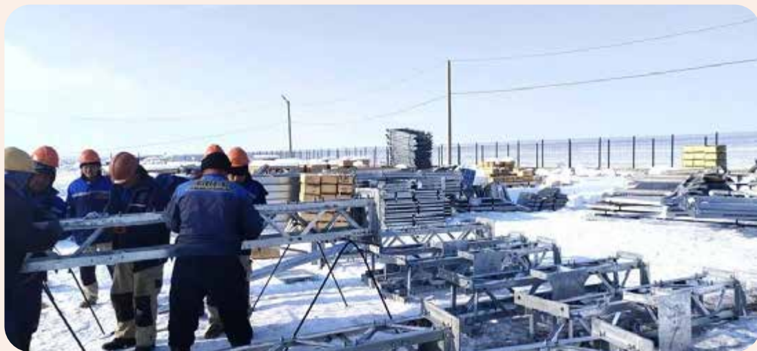
扎法拉巴德 220 千伏變電站項目
