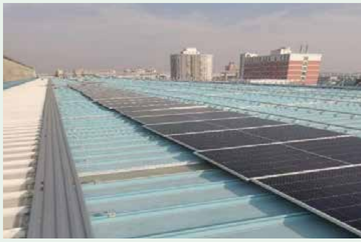
上海電氣汽輪機廠屋頂光伏
