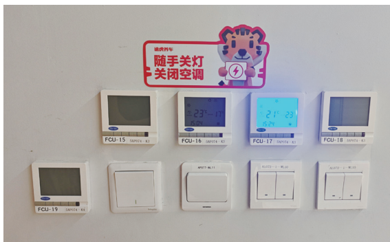
總部大樓空調溫度調節規則及節能標識
