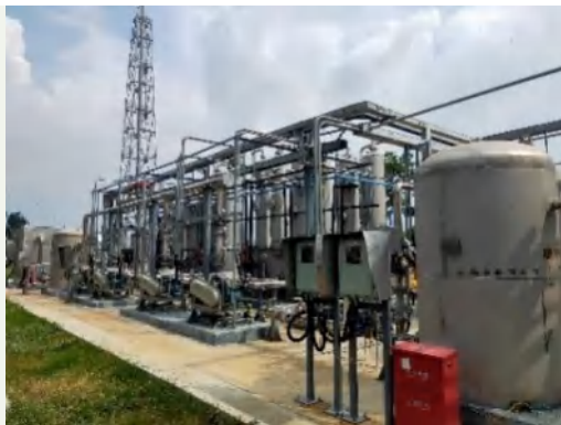
甲醛 VOCs 治理裝置
