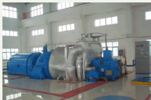
餘熱發電汽輪機
