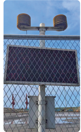
漳州碼頭港區周界設置4台揚塵噪聲監測儀，數據實時顯示
