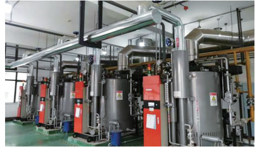
北京工廠燃氣鍋爐採用低氮燃燒器
