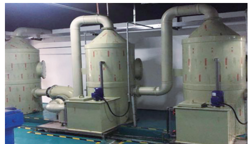
北京工廠污水處理系統採用廢氣無害化處理方式
