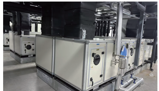
上海實驗室排風處理機組
