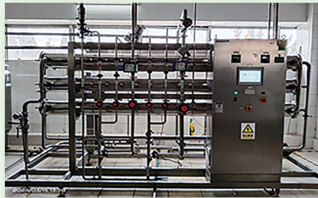
合理使用循環水塔和閉式循環系統，充分利用冷卻水循環系統
