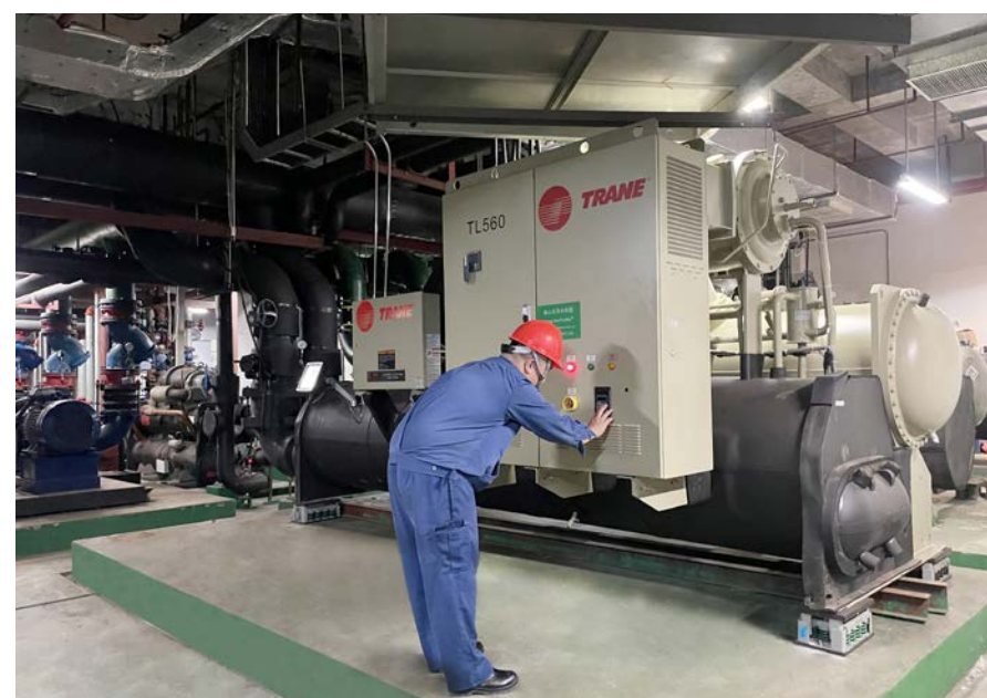
集團冷凍機設備改進項目，以提高酒店能源效能
