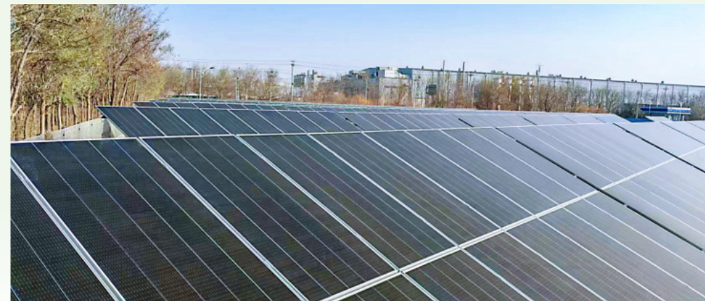
天津工廠分佈式光伏
