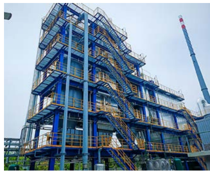
廢液廢水焚燒系統及配套的煙氣淨化裝置
