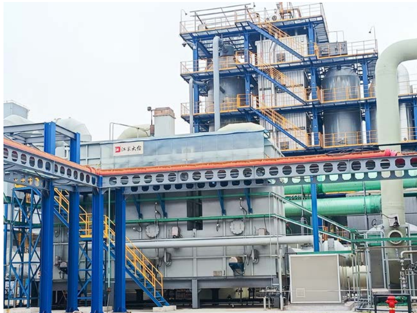
三室RTO設施
