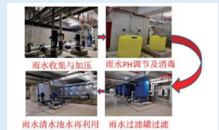
▲ 雨水及冷凝水回收利用系統
