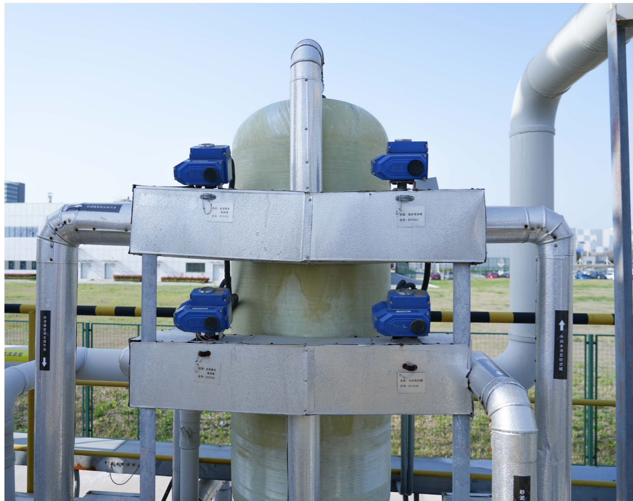
廢水處理設施
