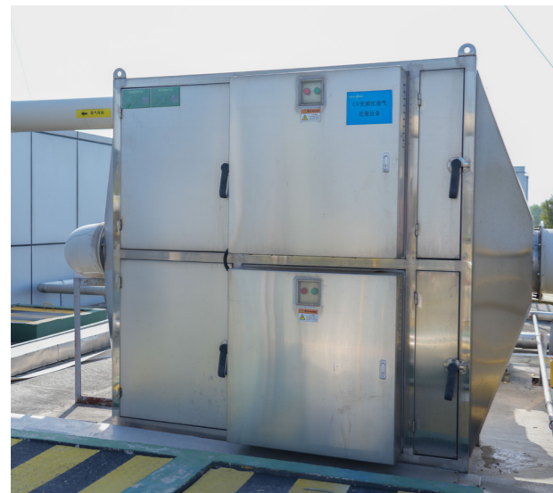
廢氣排放及處理設施
