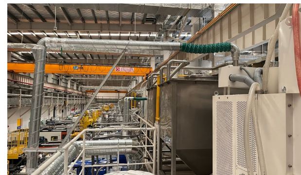
武漢斯坦雷成型車間噴淋塔 + 生物法廢氣處理設施
