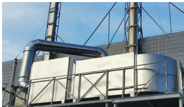
廣州安斯泰莫電泳車間氣旋塔及雙極活性炭吸附處理工藝
