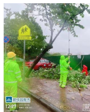
樹木倒塌及時清除
