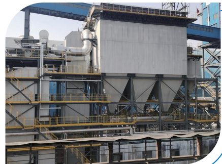
焦爐脫硫脫硝除塵項目
