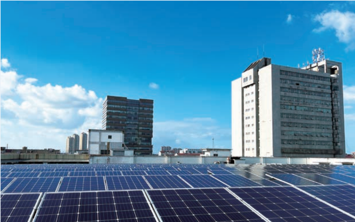
蘇州綠譜工商業分佈式光伏發電項目
