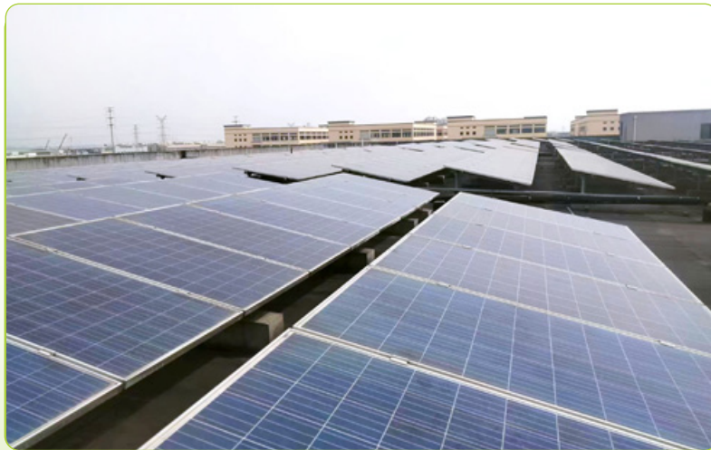
☀ 九陽光伏發電設備
