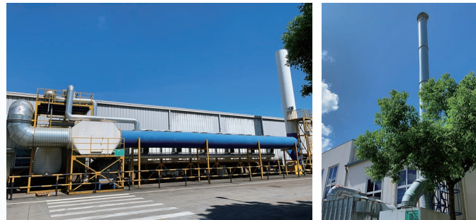
VOCs及氨氣收集處理
