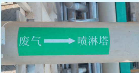
廢氣收集管道
