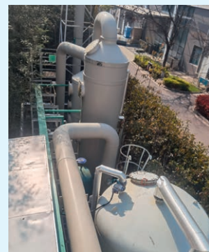
廢氣兩級噴淋處理裝置
