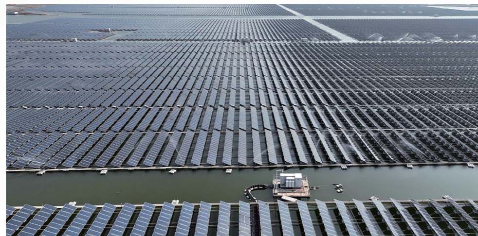
淮北(煤炭塌陷區)漂浮光伏電站
