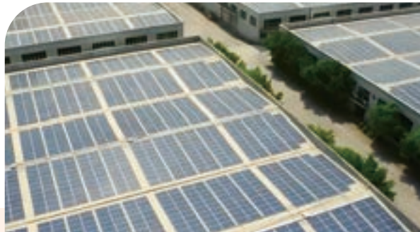
廠房屋頂太陽能光伏板
