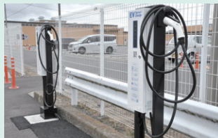
6 千瓦電動車充電站
