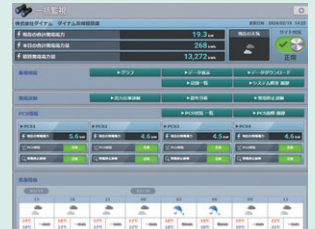
顯示資料以管理遊戲館屋頂的太陽能板所產生電力
