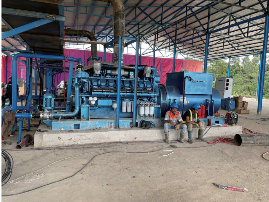
圖6：一礦安裝之發電機
