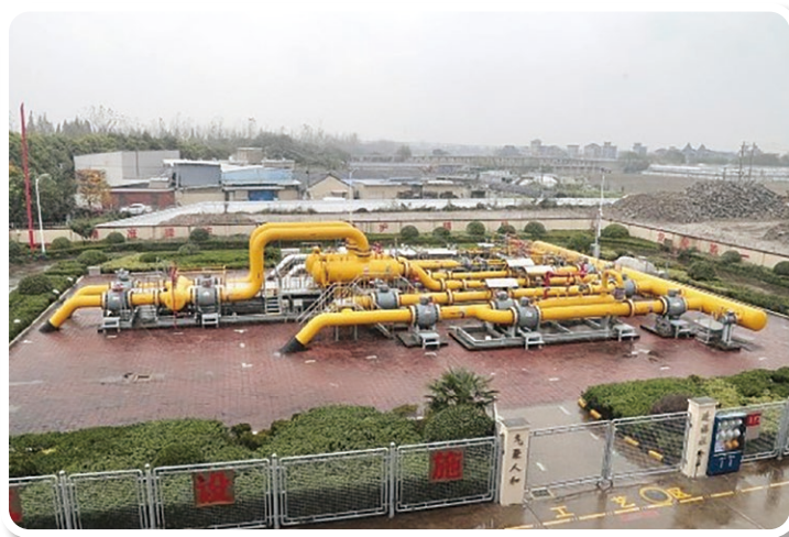
圖：智慧燃氣場站 — 杭州河莊供氣站
