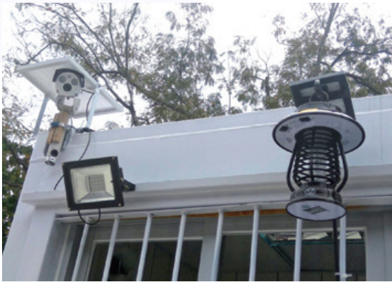
太陽能照明燈及滅蚊器
