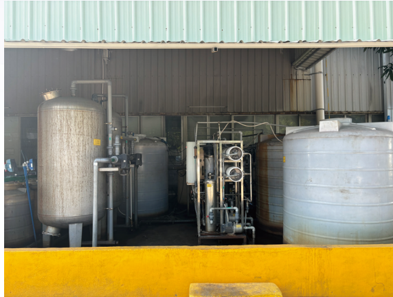
Sewage treatment system 污水處理系統
