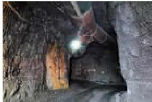
主斜坡道通風管
