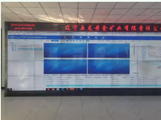
五龙矿业尾矿库在线监测系统
