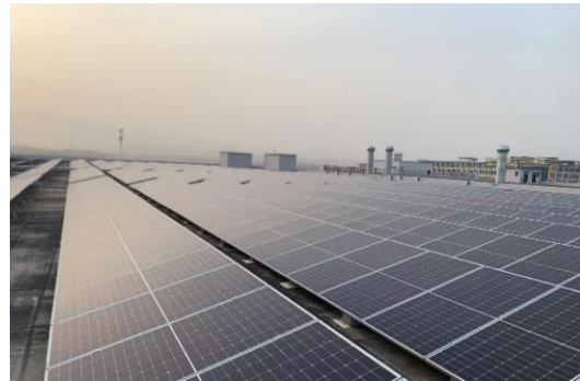
聖都工業園屋頂光伏項目
