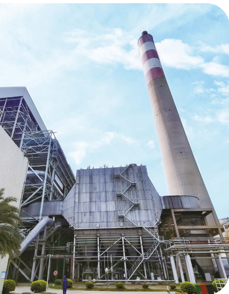
▶ 中國內地的金灣發電廠，透過提升設備可靠度以增加供熱量。
