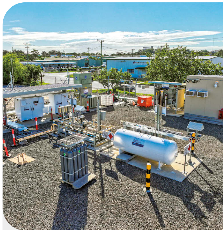
Hydrogen Park Gladstone 是 AGN 位於澳洲昆士蘭省的可再生氫能生產設施，透過一個運用水和經認證的可再生電力操作的電解槽，為公司的燃氣供應減碳。
