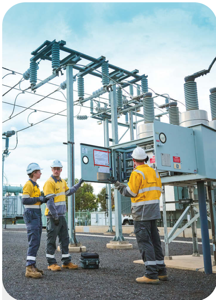
為應付夏季電力需求增加，United Energy 加強旗下 16 個配電變電站，以支援墨爾本東南部和摩寧頓半島的 2,000 多名客戶。
