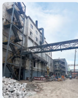
某餘熱發電設備
