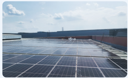
某光伏電站項目
