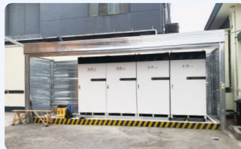
上海市奉賢區某儲能電站項目
