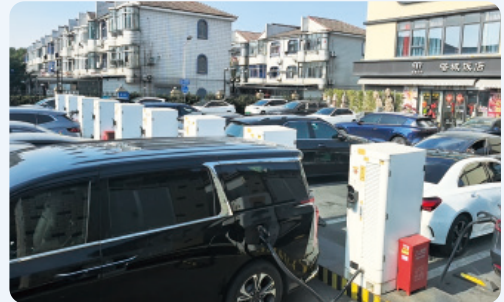
某汽車充電樁場站
