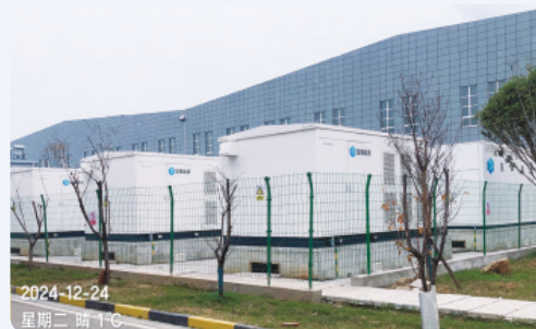
湖南省10MW/20MWh儲能電站項目
