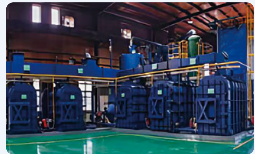
某原料處理加工設備
