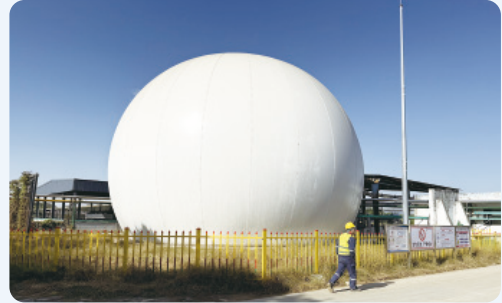
某沼氣發酵設備
