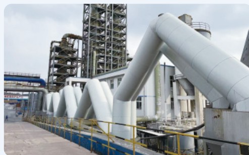
改良後的生產設備
