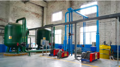
三山島金礦污水循環治理
