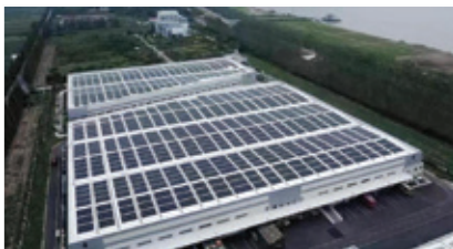
漢南捷悅行光伏發電項目
