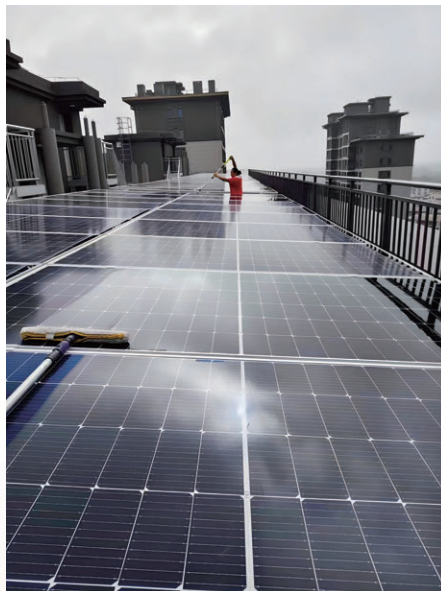
光伏組件 Photovoltaic modules
