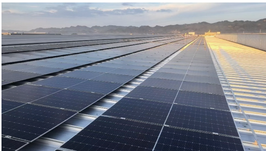
Rooftop solar panels 屋頂太陽能板
