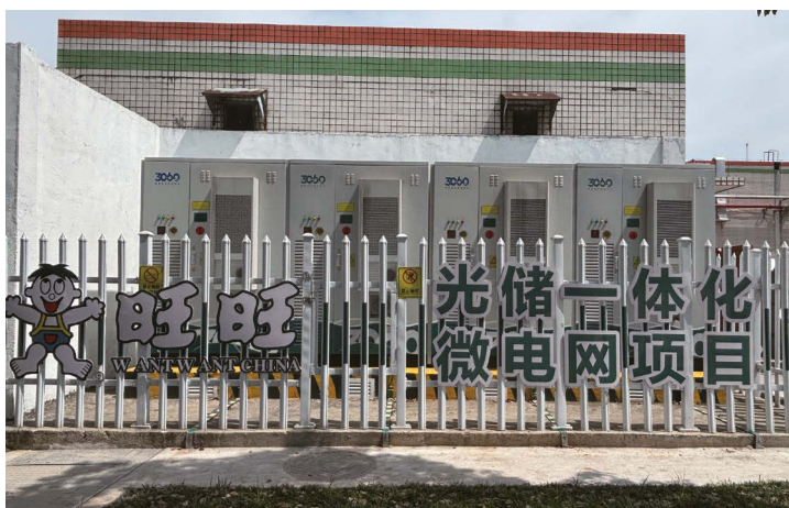
「光儲一體化」微電網項目 “Photovoltaic-Storage Integrated” Microgrid Project
